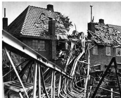
Een omgevallen NSF mast in Hilversum
